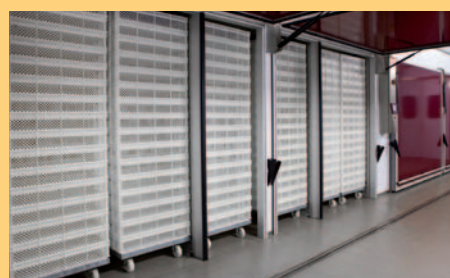
Vista de las nacedoras en la planta ter Heerdt
